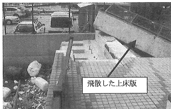
写真-1 台風18号の波により被災した上部工の例
